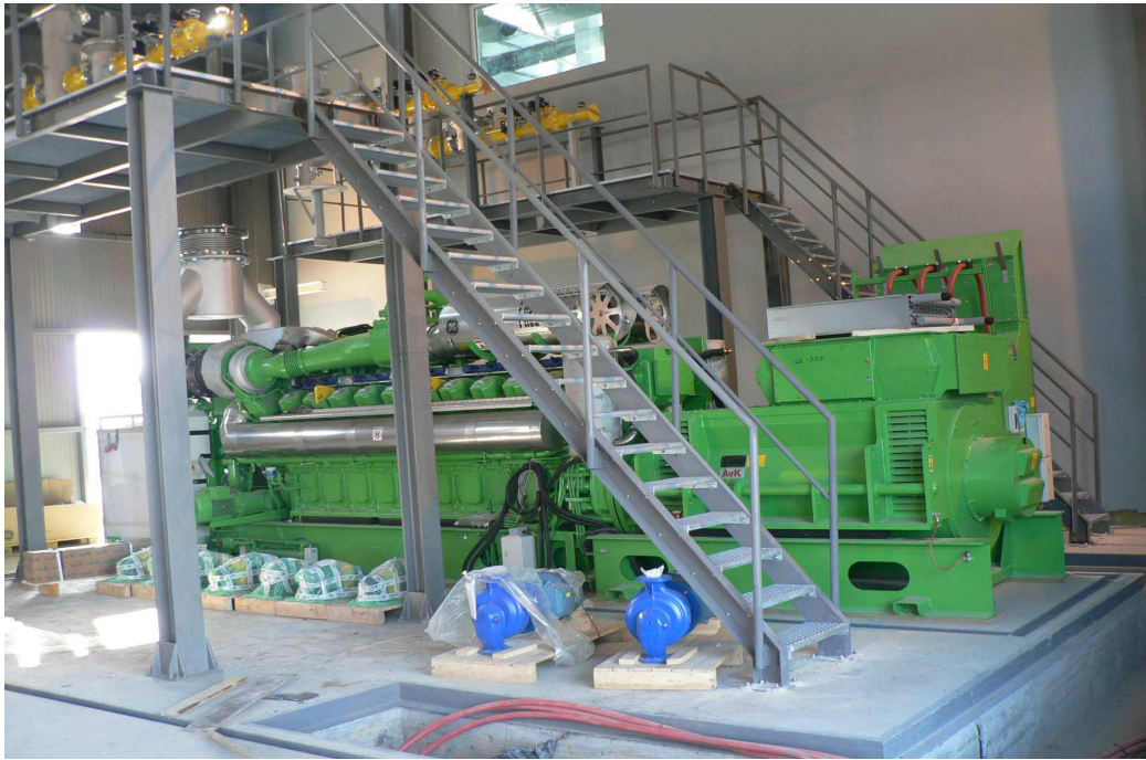
Motor de combustión de General Electric - Jenbacher J620 correspondiente a la primera fase de 2Mw
